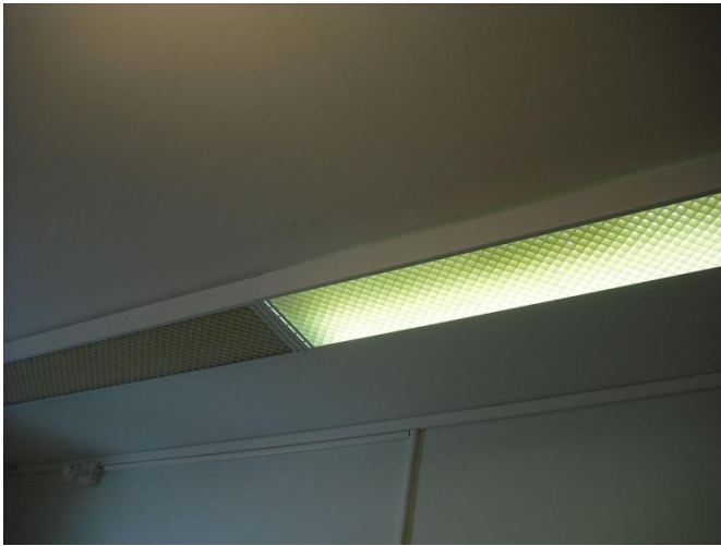
Figur 10: Lysrörsarmatur i tak, vådrum avd. 15.
